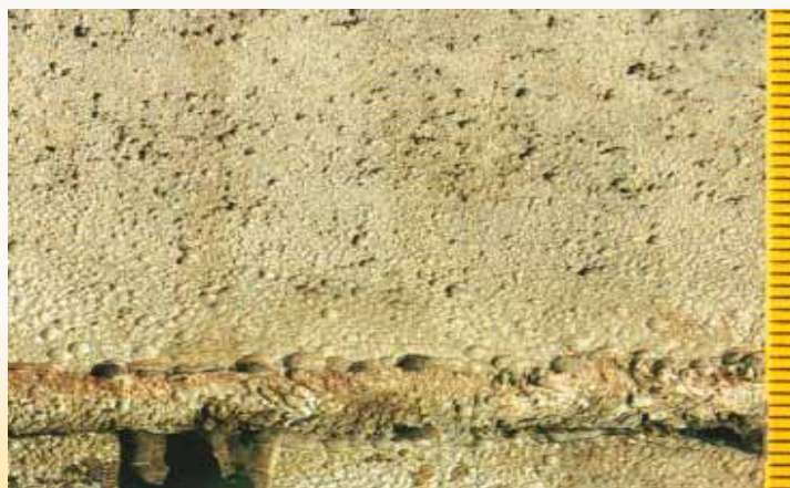
Figuur 2: Putcorrosie, vooral geconcentreerd op de gelaste zone, door chloridehoudend water in een AISI 316 Ti gestabiliseerd austenitisch roestvast stalen onderdeel van een afvalverwerkingsinstallatie
