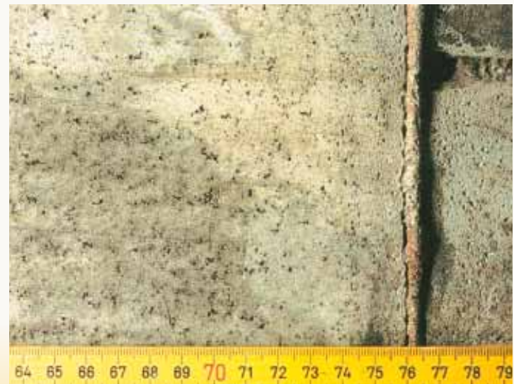
Figuur 8: Knifeline attack (verticale lijn direct links naast de las) in AISI 316 Ti voorkomend in dezelfde installatie waarvan reeds een detail getoond werd in figuur 2
