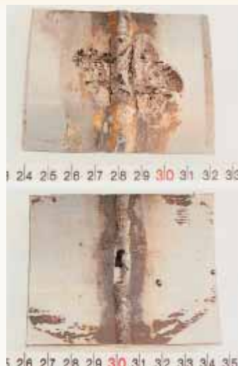
Figuur 1: gelocaliseerde corrosieve aantasting in een 2205 duplex roestvast stalen pijpsysteem (boven: buitenkant, onder: binnenkant van de pijp) door aanwezigheid van thermische oxides in de laszone
