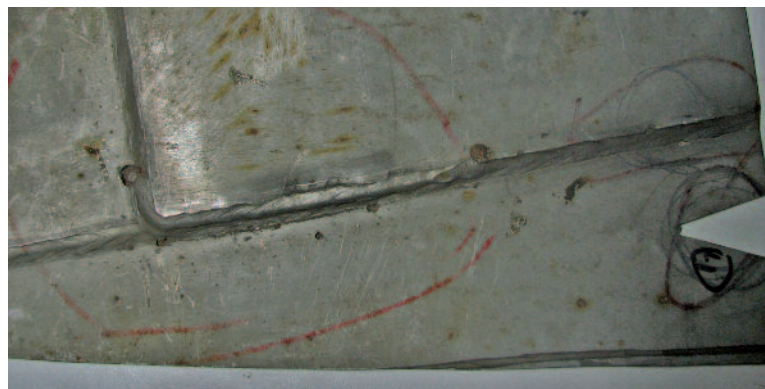
Figuur 4a: ijzercontaminatie op het RVS
