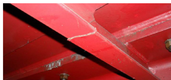
Figure 3: Rupture de fatigue dans un rail de grue
